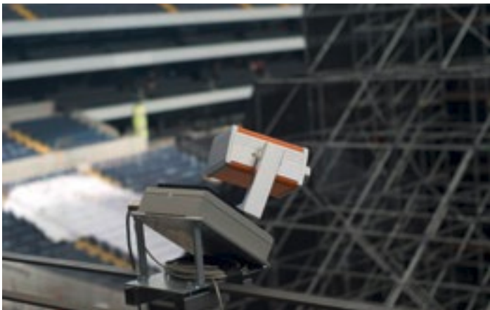
Erfassen von großen Detektionsbereichen: Das PYROsmart-System scannt laufend die gesamte Rückseite der 412 m 2 großen Videoleinwand ab
