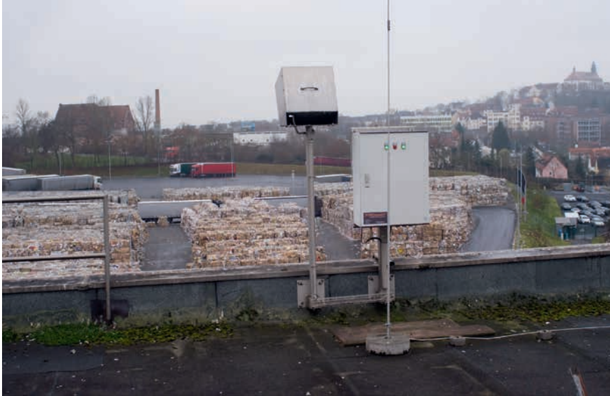
Das patentierte Pyrosmart-System, das auf Infrarotthermografie basiert, ist auf dem Dach der Produktionshalle montiert und kann Hot-Spots frühzeitig erkennen.
