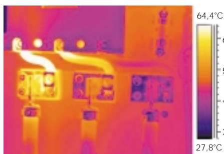
Anschluss mit hohem Übergangswiderstand
