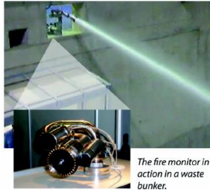
Der Löschmonitor in einem Müllbunker in Aktion.
