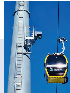
Das Pyrosmart-System an der zweiten Stütze überwacht den Bereich unterhalb der Seilbahn. Fotos: ORGLMEISTER
