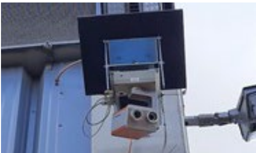
Ein einziges PYROsmart®-System, das an der Ecke der Halle montiert ist, überwacht den kompletten Bereich.
