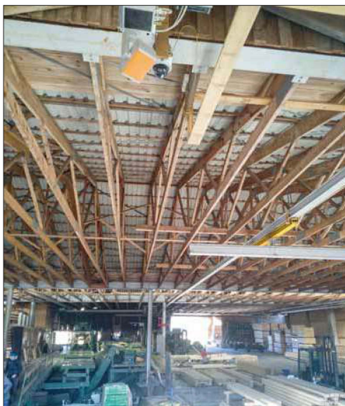
Das Sägewerk Obermaier in Irschenberg hat zum Brandschutz Infrarottechnik in der Produktions- und Lagerehalle installiert.
