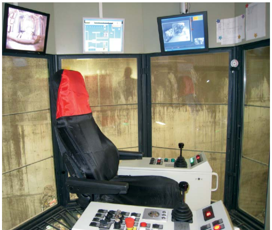
▲ Müllbunker-Krankanzel: Blick in den Führerstand
