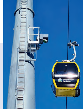
Das Pyrosmart -System an der zweiten Stütze überwatcht den Bereich unterhalb der Seilbahn. Fotos: ORGLMEISTER
