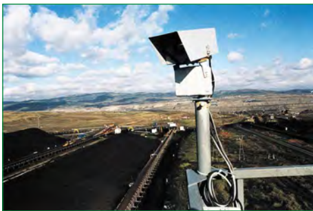
Bild 5: Älteres IR-Brandfrüherkennungssystem (etwa 1990)
