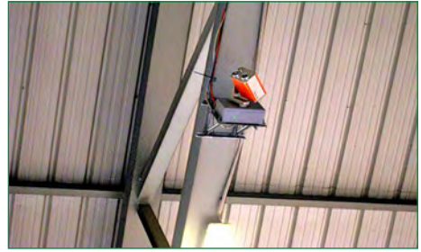
Bild 18: Deckenmontage eines IR-Brandfrüherkennungssystems
